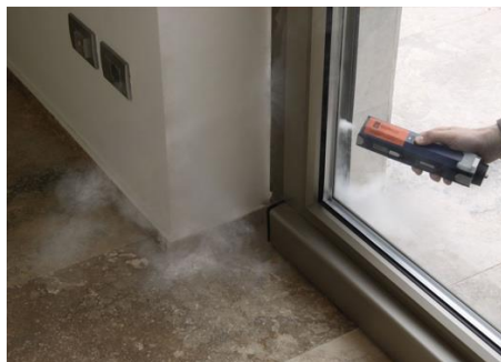
Slika 168 Detekcija mjesta pukotine (curenja) pomoću generatora dima
