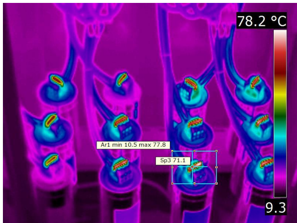
Slika 97 Automatsko prepoznavanje mjesta najviše prividne temperature (termogram prikazuje snimak kondenzatorskih baterija za kompenzaciju jalove snage, mjereno u TS 10/0.4 kV/kV Omial)
