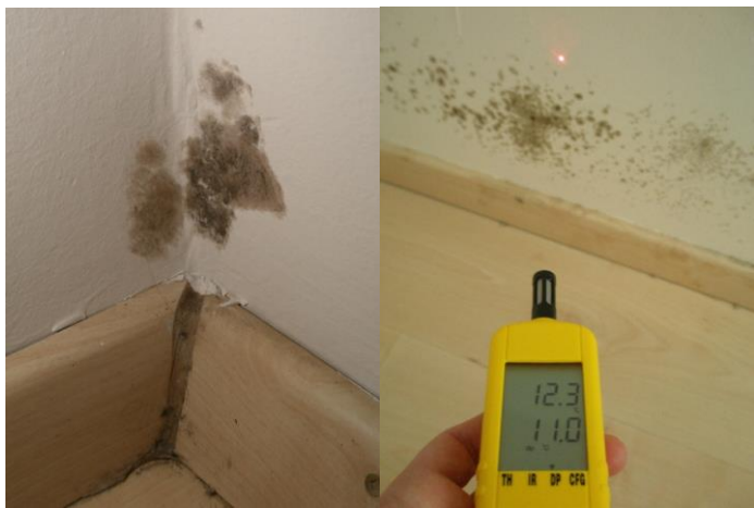
Slika 146 Gljivice i pljesni te termo-higrometar-pirometar za utvrđivanje uvjeta kondenzacije
