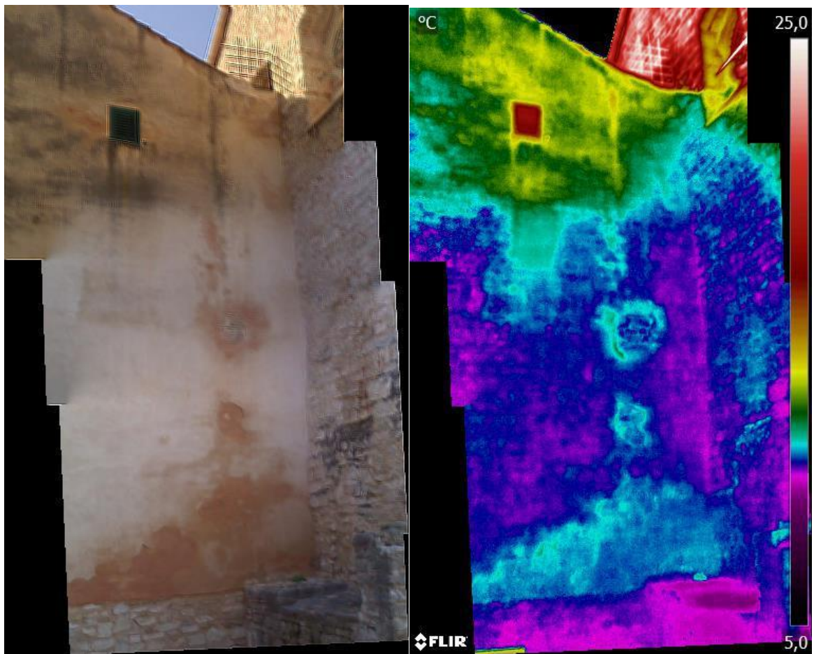
Slika 135 Vlaga u zidu zgrade iza katedrale sv. Duje
