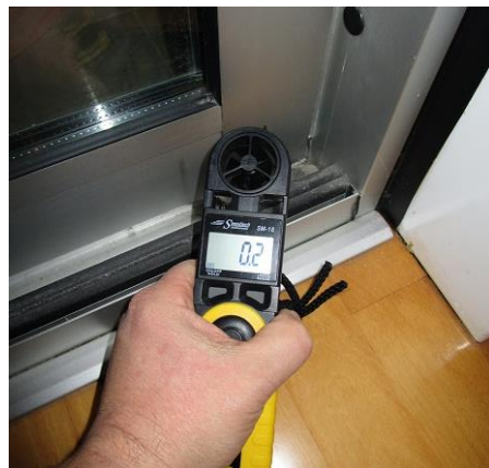
Slika 169 Detekcija mjesta pukotine (curenja) pomoću anemometra
